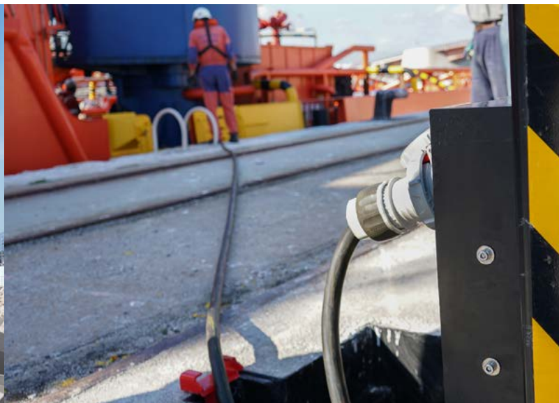
Prueba de una innovadora conexión en buque para futura electrificación Test of an innovative vessel connection for future electrification
