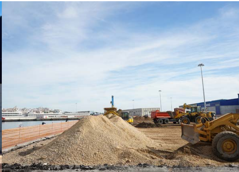
Nueva pavimentación en el muelle de Aragó New paving on the Aragó Wharf
